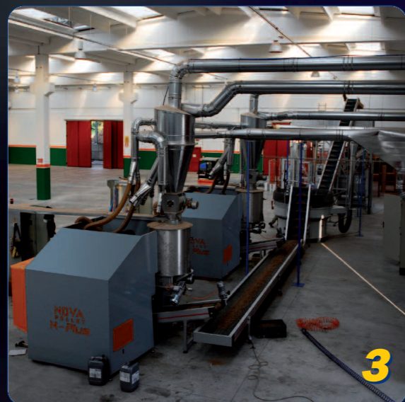
3 Caricamento - pellettizzazione - vagliatura 3 Chargement - granulation - criblage et refroidissement 3 Carga - granuladoras - enfriadores y tamizadores
